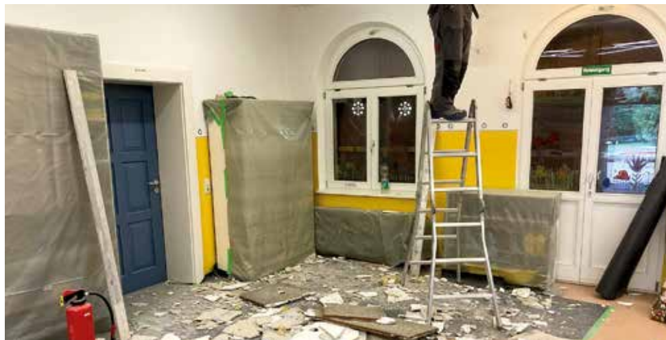
UNSER STADTPARKKINDERGARTEN, DER SEIT 2021 AUF SEINE SANIERUNG WARTET
